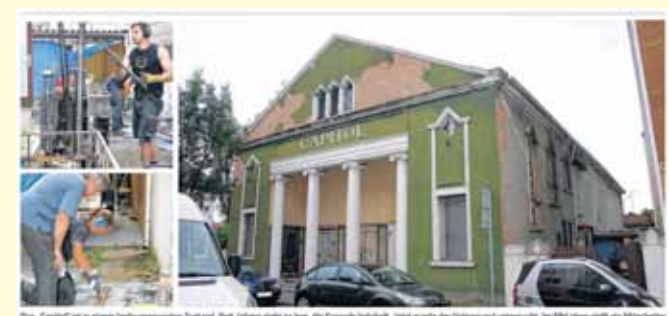
Das „Capitol“ ist in einem baufälligen Zustand. Seit Jahren steht es leer, die Fassade bröckelt. Jetzt wurde der Untergrund untersucht. Im Bild oben steht ein Mitarbeiter des Bauamts, der einen Meter tief in die Erde blickt. Im Bild unten schauen wir ins Innere des Gebäudes, das im Inneren völlig baufällig ist.
